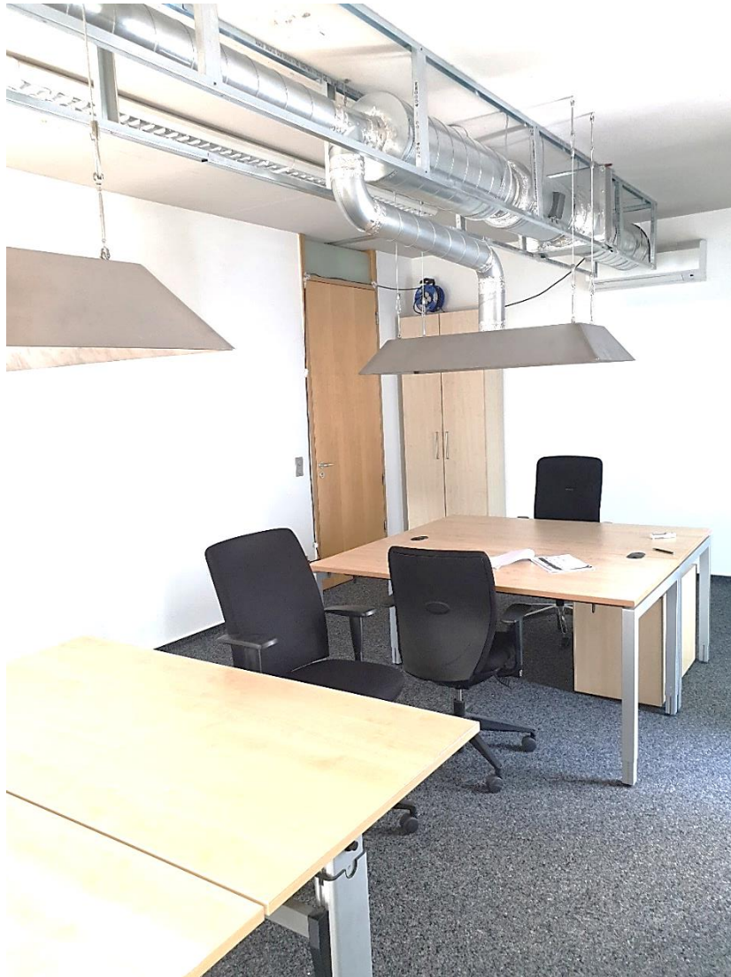
Foto 1: Lufttechnisches SARS-COV-2-Schutzsystem für Büro- und Aufenthaltsräume (Versuchsanlage)
